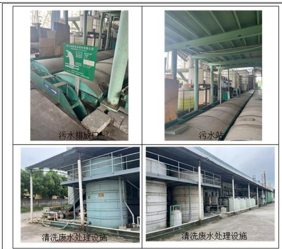
图 3-3 废水处理设施现状
