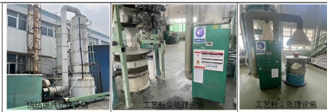
图 3-5 烧结废气处理设施现状
