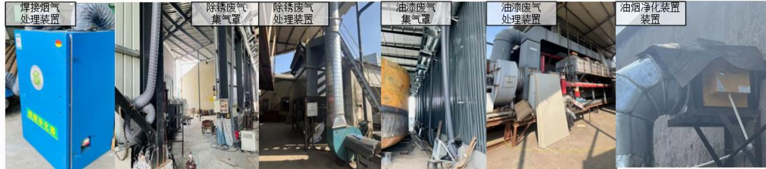
图 3-2 废气收集及处理设施现状
