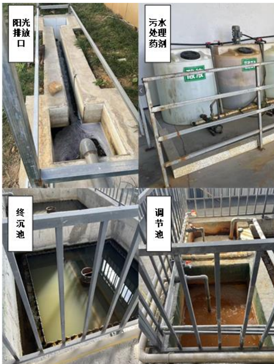
图 3-2 废水处理设施现状
