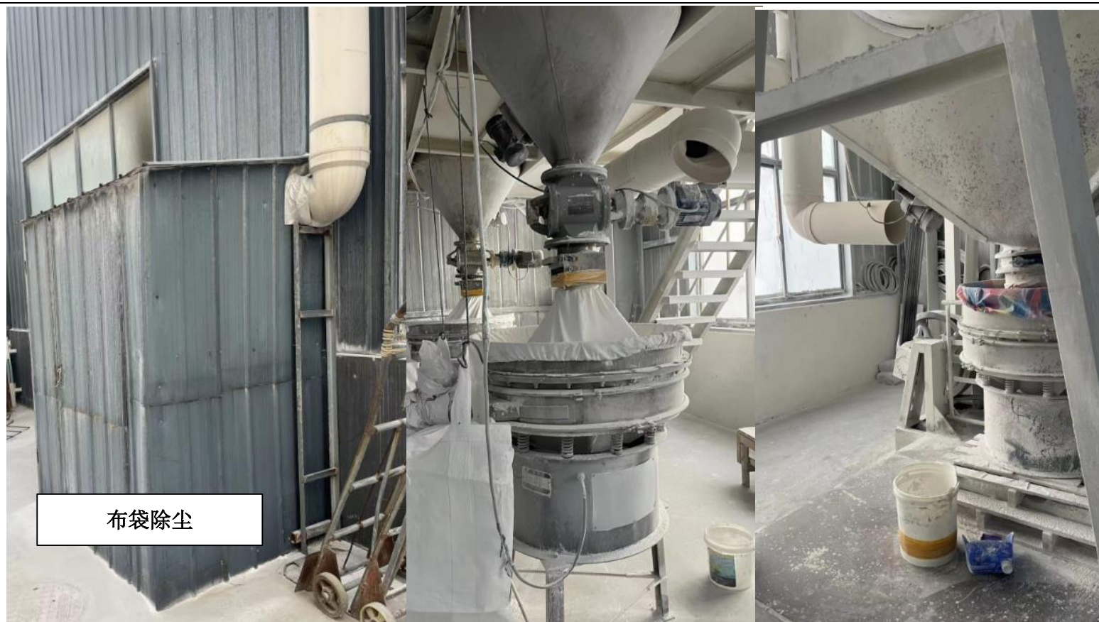
图 3-2 废气处理设施现状
